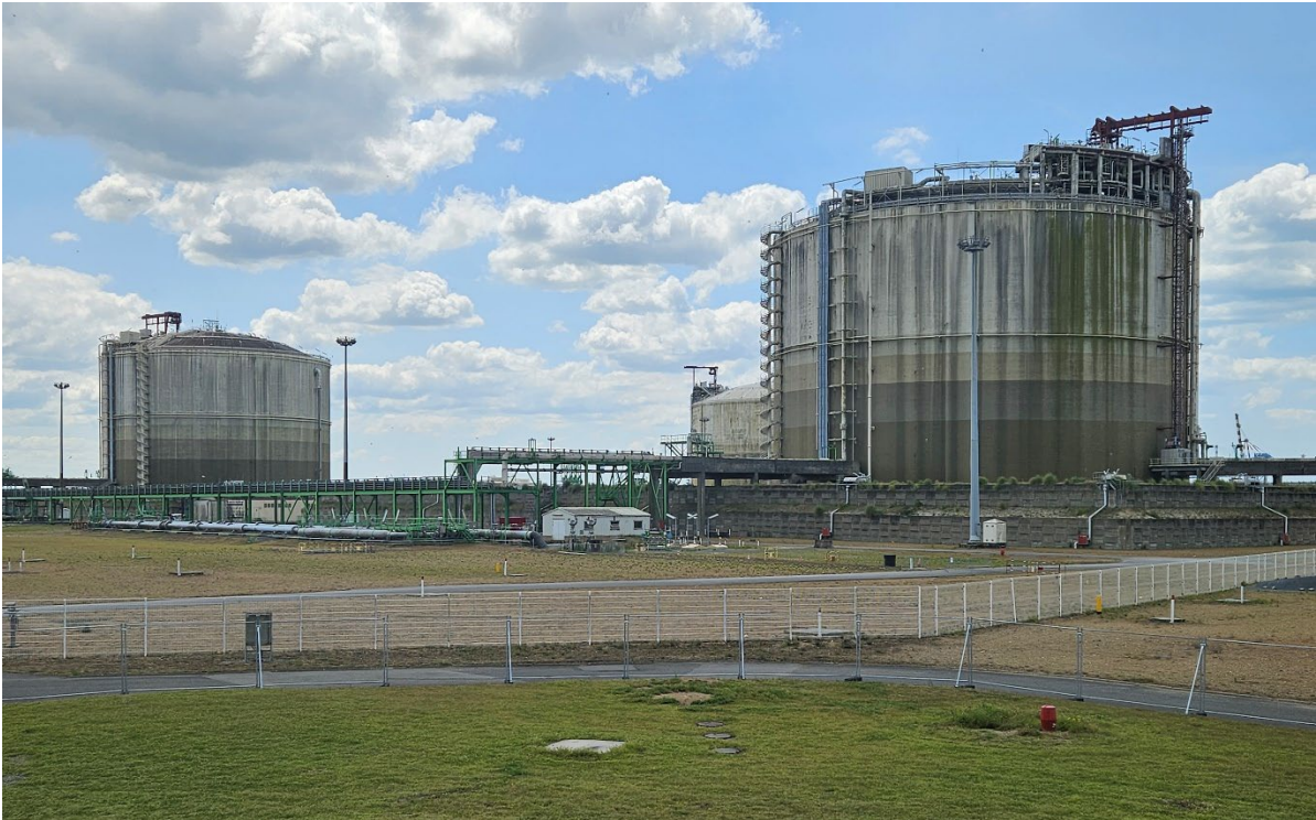
LNG storage tanks (containing 120,000m3 LNG each) at the Montoir LNG terminal.
